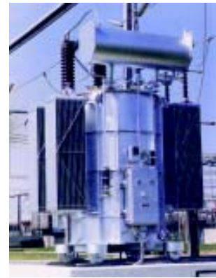
消弧线圈（110Kv）
