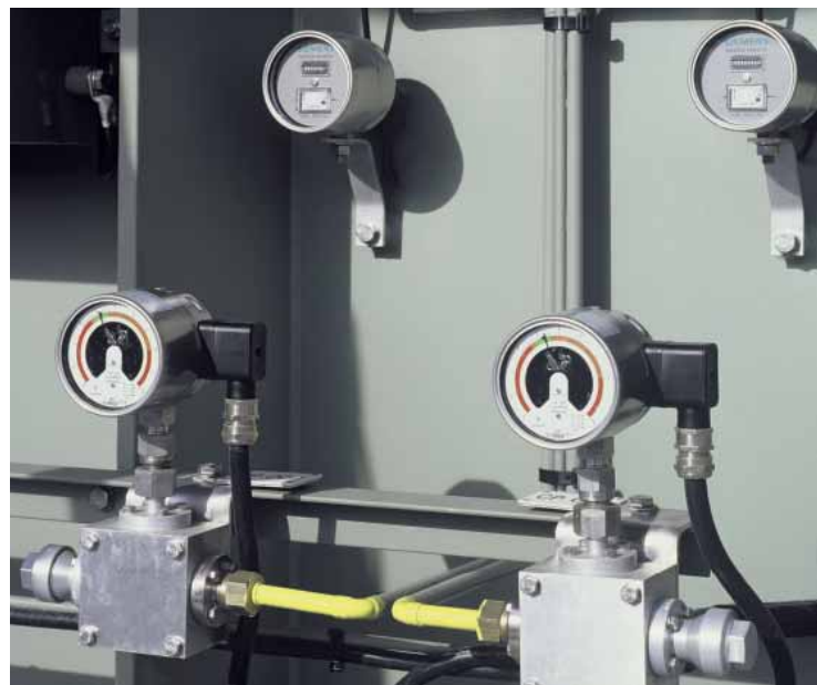
GIS避雷器的气体及电气监测装置
