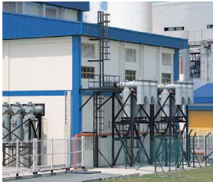
连接到420千伏GIS高压开关母线的GIS避雷器
