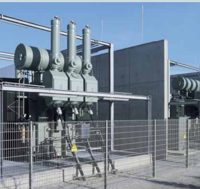
安装在123千伏变压器上的带油-SF 6 套管的GIS避雷器
